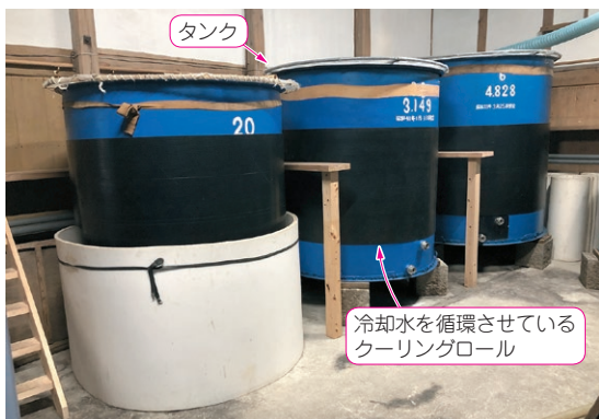
写真1 お酒の発酵管理を安定して行うためにタンクの外側に冷却水を循環させる
