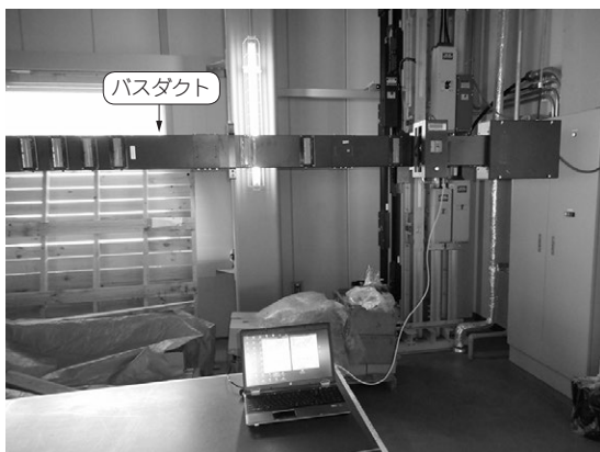
写真1 金属製のシャーシで囲われたバスダクトの概観 写真提供：共同カイテック神奈川技術センター
