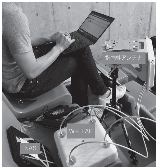
写真1 ポータブル競技場内映像配信設備
