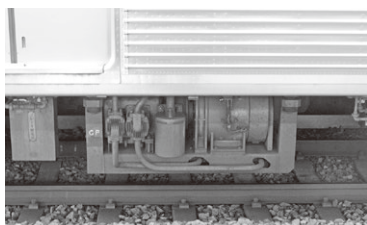
写真1 車両下に搭載された電動空気圧縮機
