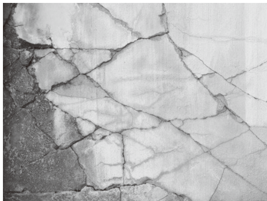
図1 コンクリート上にできたひび割れ(今回の検出対象)
